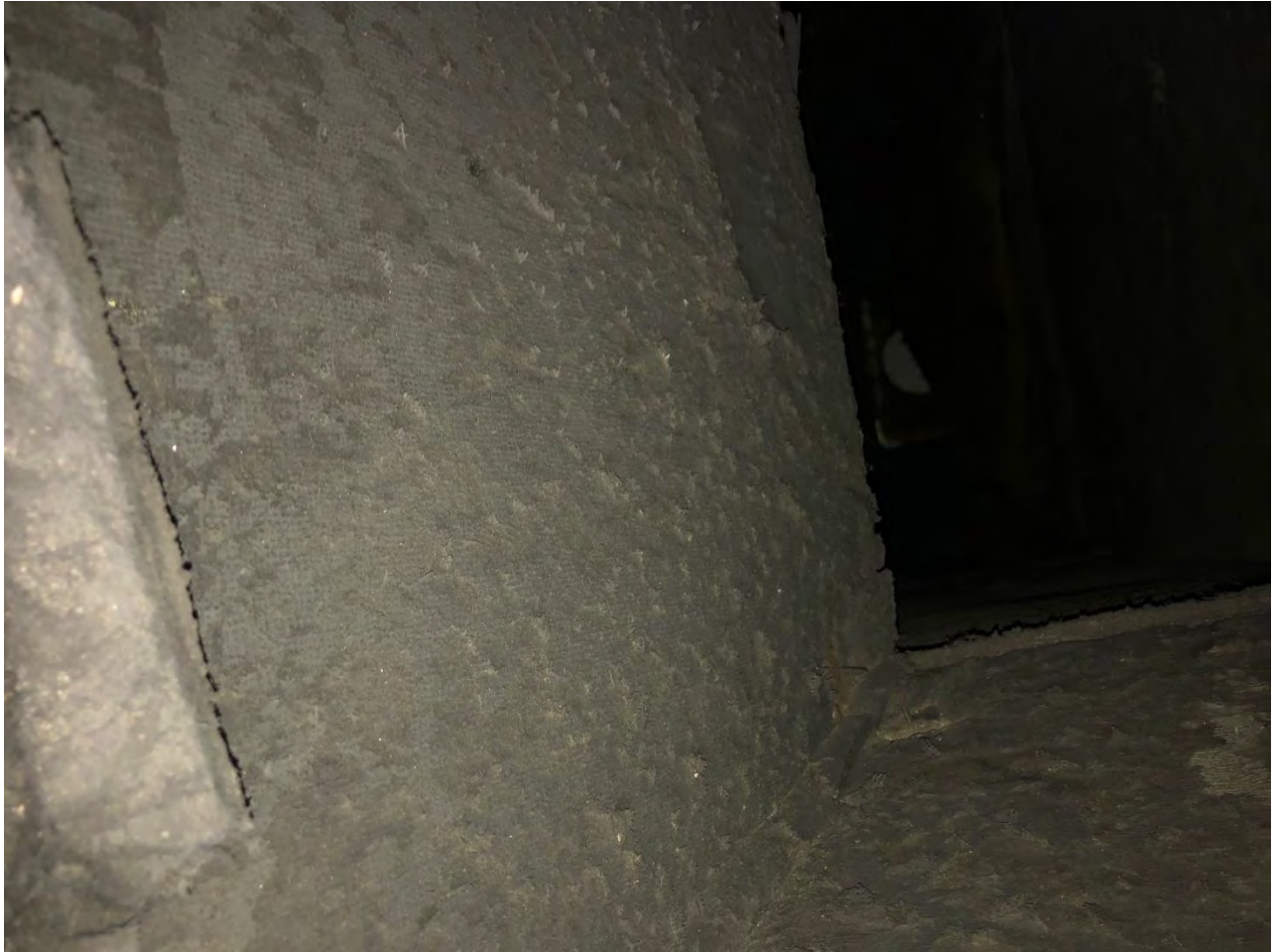
Photo 7) Dépôts des poussières et croissance fongique aux parois à l'intérieur de la gaine.
