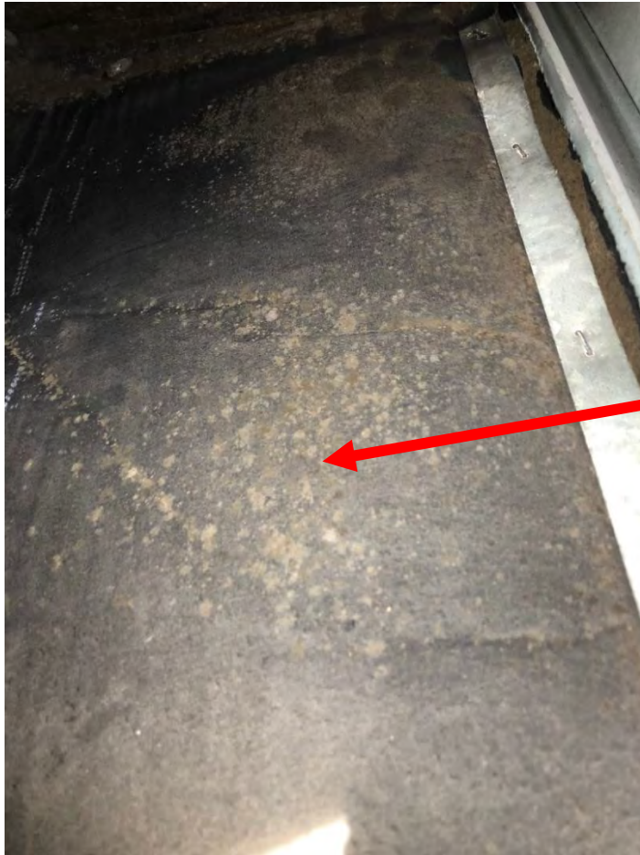
Photo 5) Taches sur l'isolant à l'intérieur de la gaine de ventilation indiquant les moisissures.
